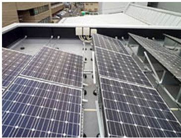
太陽光パネル(屋上)
